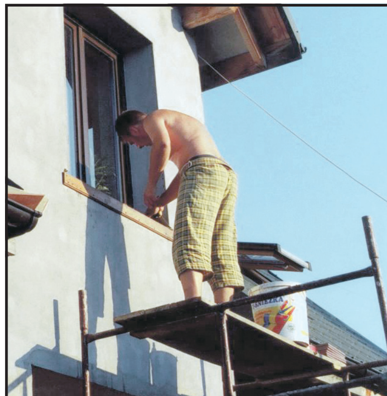
Na budowlanych często lekceważą się przepisy BHP, np. przy pracy na wysokości
