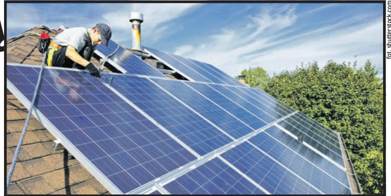
Montaż instalacji w miejscowościach, które otrzymają dofinansowanie będzie mógł rozpocząć się już w przyszłym roku
